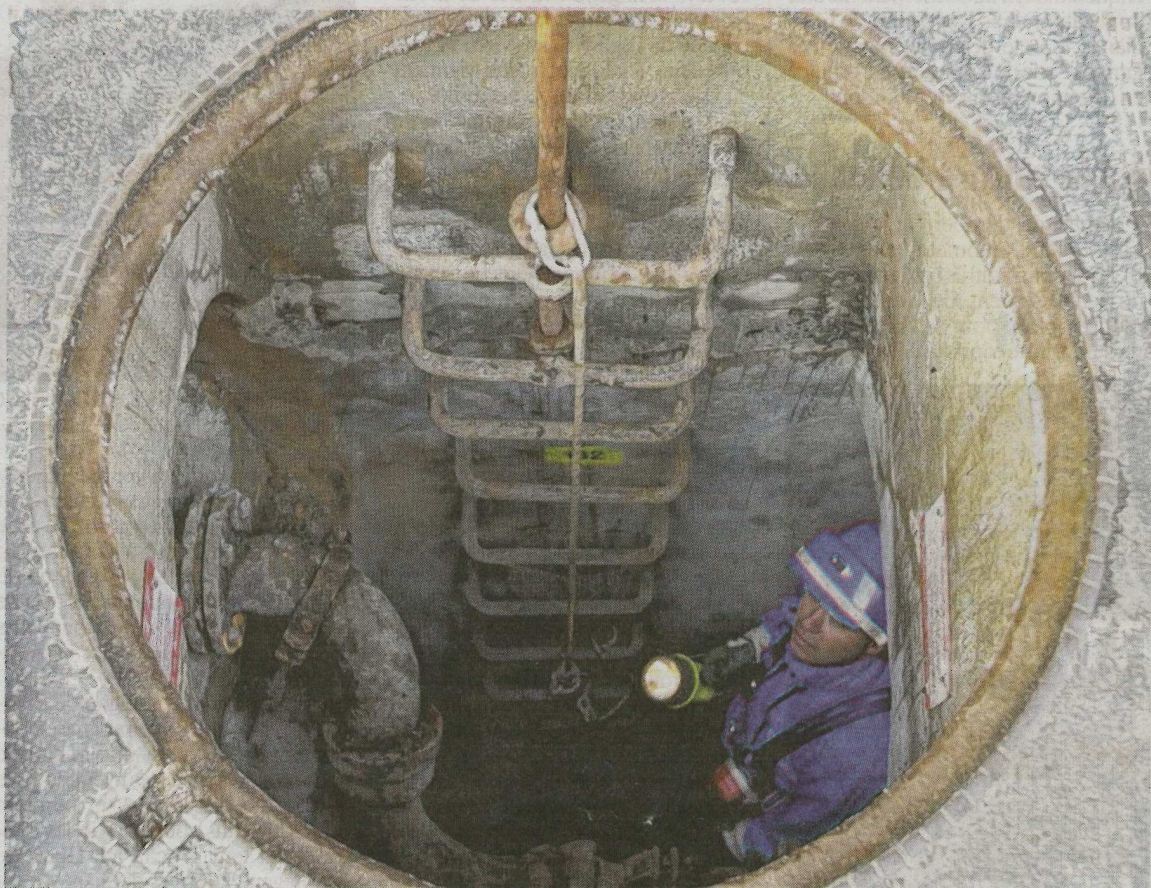
De l'amiante, matériau cancérigène dont l'usage est interdit en France depuis 1997, a été découvert sur le brai de houille qui protège certaines canalisations d'eau potable.
